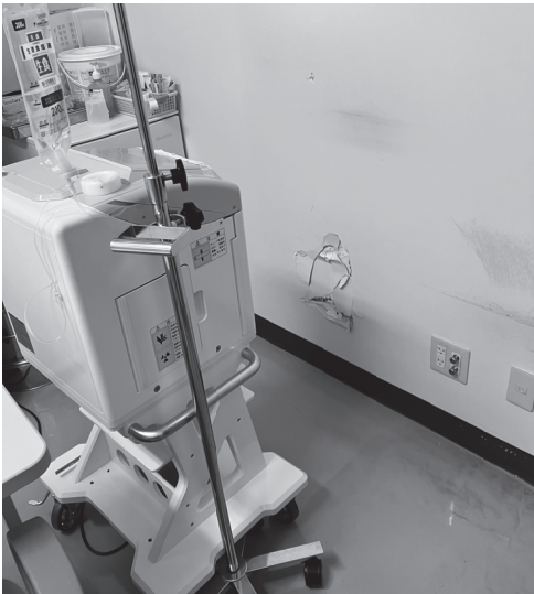
写真1 FDG 投与機による壁の破損写真
