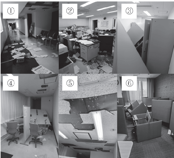
写真1 被災直後の健康管理センター内の様子 ①受付前 ②事務室 ③更衣室 ④採血コーナー ⑤④から数日後の採血コーナーの天井 ⑥ラウンジ
