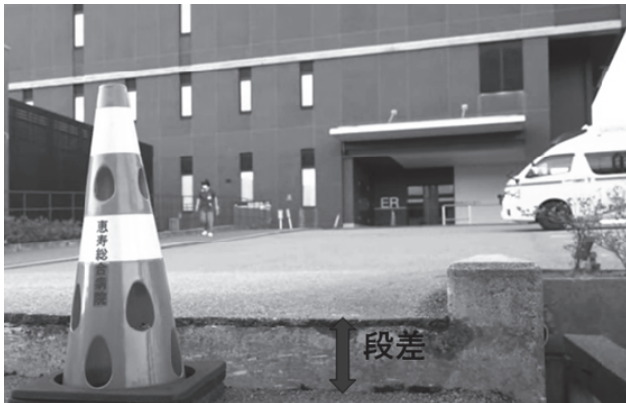
写真 2 救急車搬入口に生じた段差
