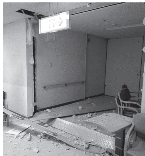
写真 1 併設施設との接続部破損
