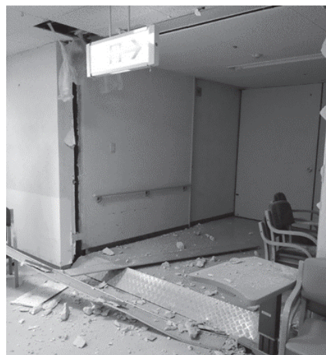
写真 1 併設施設との接続部破損
