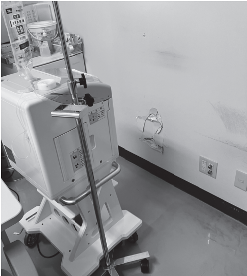
写真1 FDG 投与機による壁の破損写真
