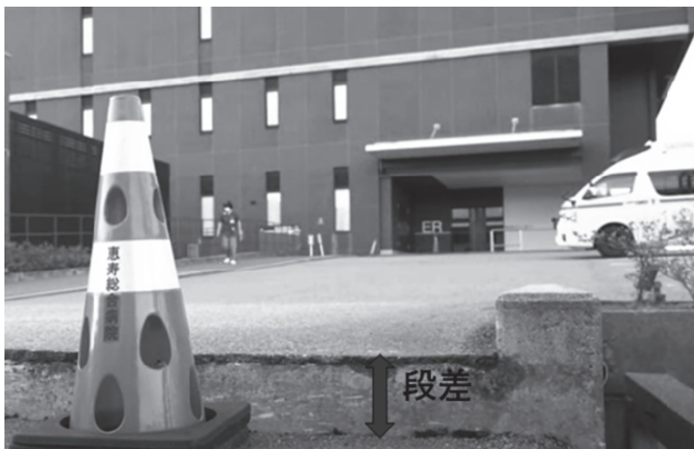
写真 2 救急車搬入口に生じた段差
