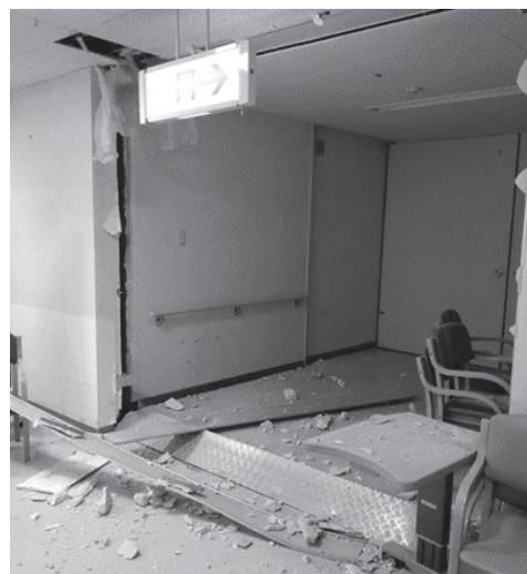
写真 1 併設施設との接続部破損
